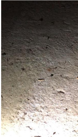
Abb. 1: minimale Kotspuren südliches Widerlager
