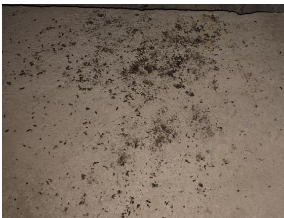
Abb. 9: größere Ansammlung von Kot im westlichen Hohlkasten bei Pfeiler 6
