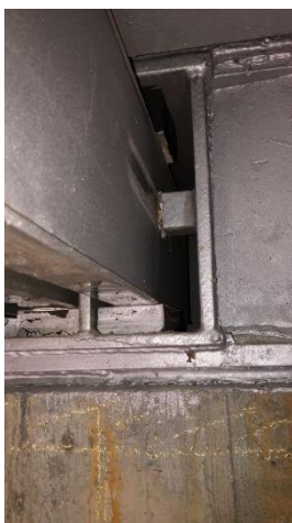
Abb. 21: Bsp.: nicht einsehbare Hohlräume im Widerlager
