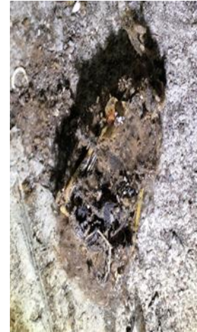
Abb. 14: Fledermauskadaver im Pfeiler Nr. 6 Ost
