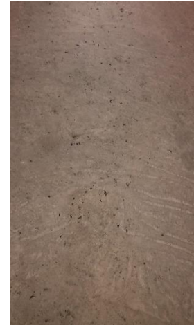
Abb. 4: Bsp. Kotspuren im Hohlkasten unter dem Kabelschacht
